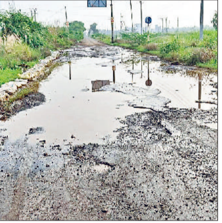
झज्जर। कच्चा सुर्खपुर मार्ग की टूटी हुई सड़क पर जलभराव।
